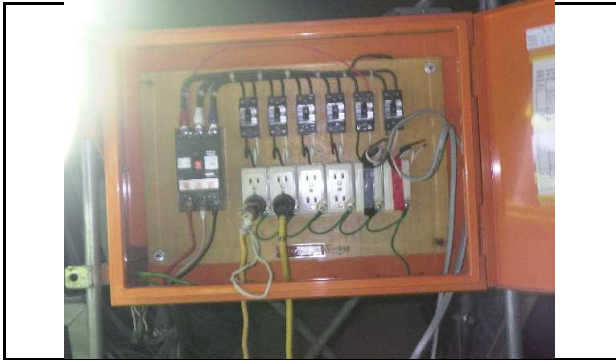
①分電盤内のプラグに行き先表示をする
