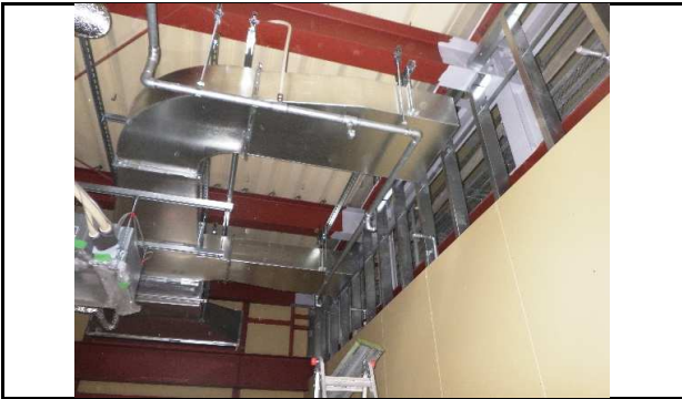
ガス配管とダクトの取り合い確認必要
