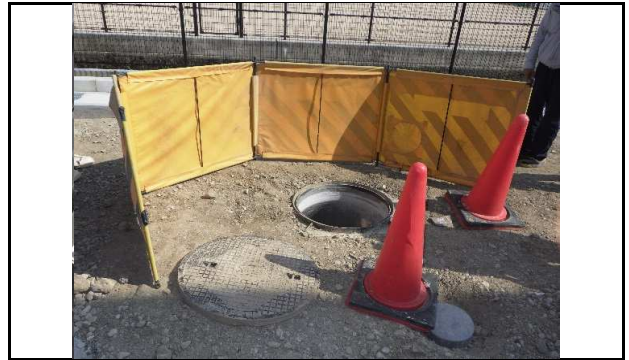
マンホール開口部の落下対策あり
