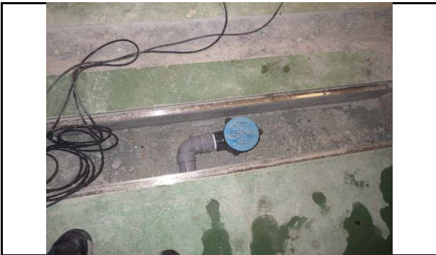
匂い防止のため床排水トラップ使用
