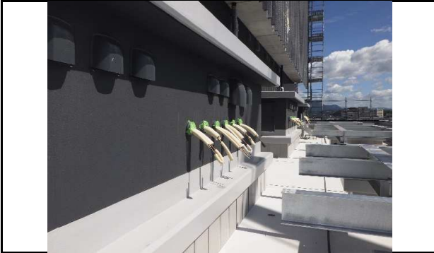
冷媒配管の雨水の差込の対策として端部を下に向けている
